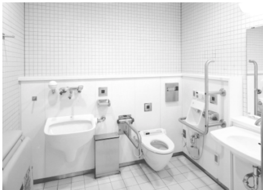
Multifunctional toilet (JR TT)
